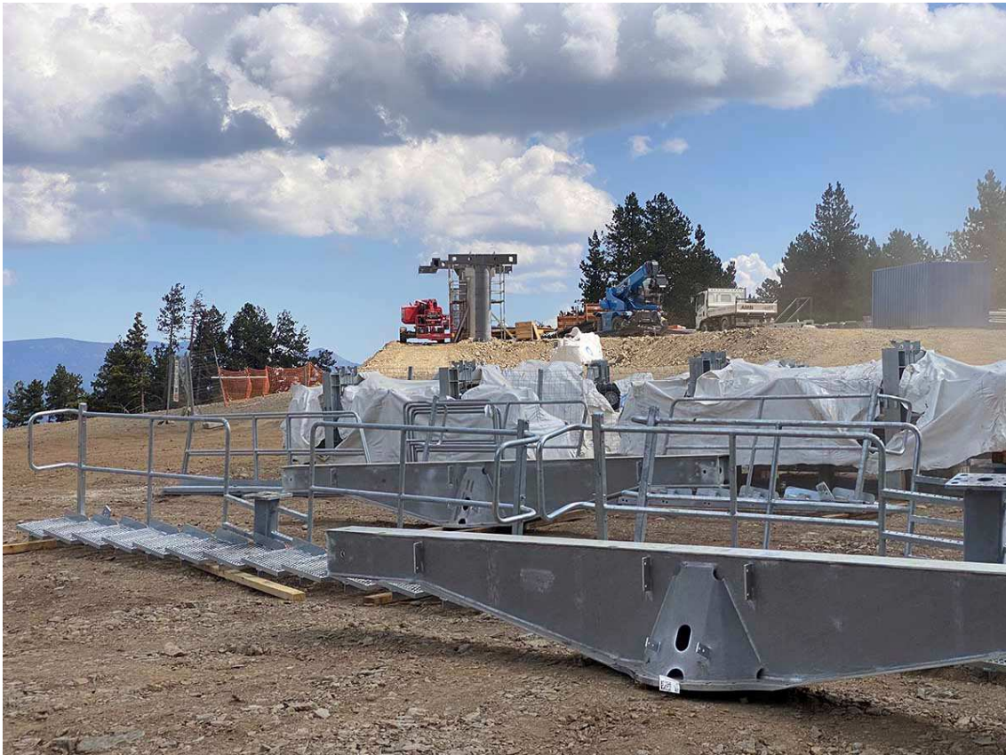
Els balancins de la part superior de les pilones a tocar de la terminal d'arribada del telemix (Foto: Diaridelaneu).
