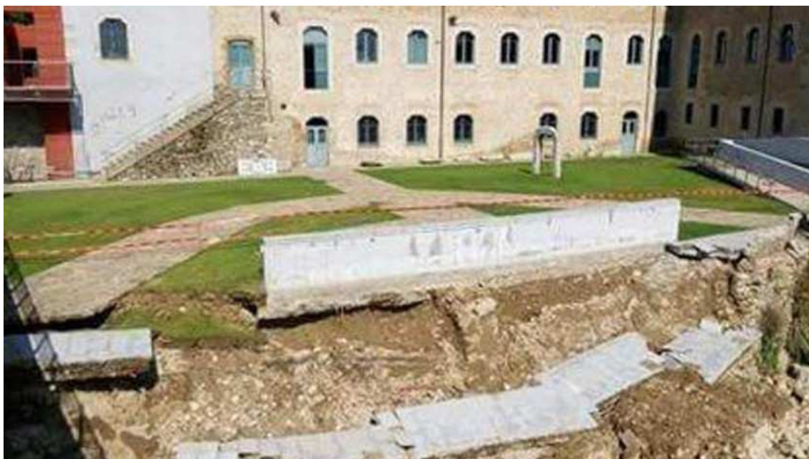
La primera gran tempesta de l'estiu del 2017 va esfondrar el mur | Regio7
