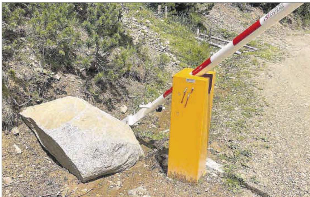
La barrera que limita l'accés en vehicle a la muntanya de Lles trencada
