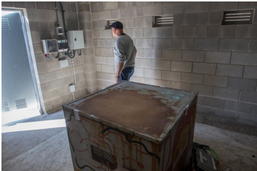
L'interior de l'edifici construït per protegir el pou de la Repsol de Caldes de Malavella QUIM PUIG.
