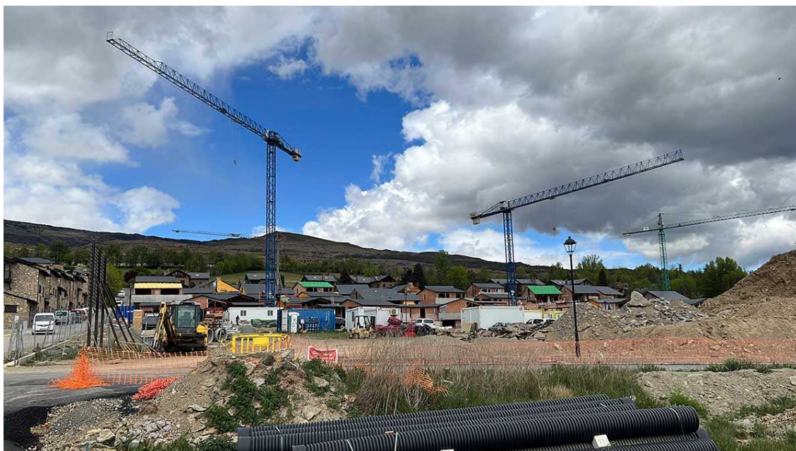
Urbanització en construcció amb xalets a mig aixecar a Ger (Foto: ACN).
