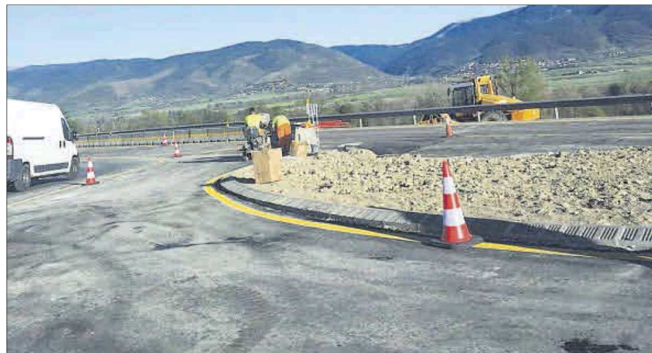
A dalt, les obres de la nova urbanització amb 70 cases. A baix, la construcció de la rotonda a l'N-260
