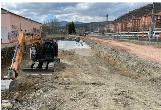
Les obres del taller provisional de trens a Ripoll AJUNTAMENT DE RIPOLL.
