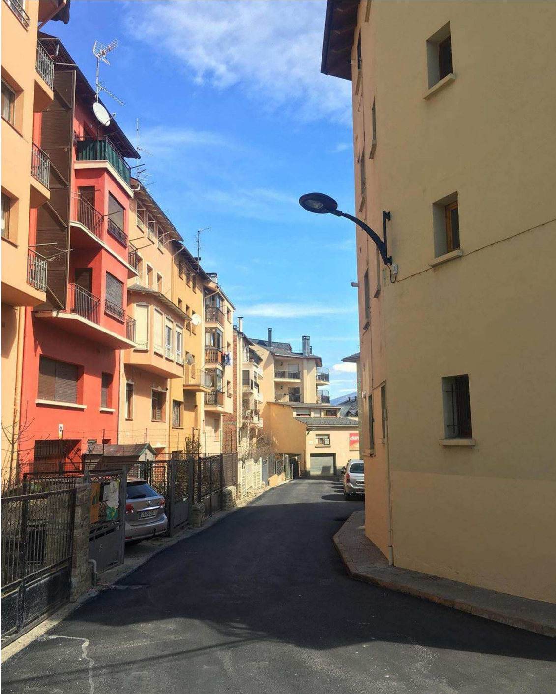
Puigcerdà executa les obres de pavimentació dels carrers Junoy i Fites i de la plaça del Triangle / puigcerda.cat
