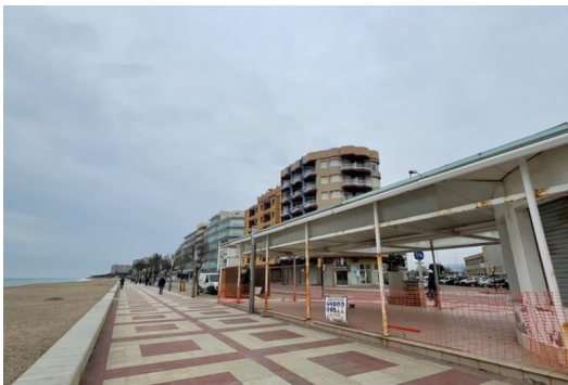
L'estructura malmesa del 'antic restaurant dels Pins, al passeig s'Abanell de Blanes AJUNTAMENT DE BLANES.
