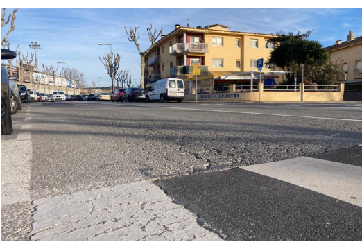
Estat d'un tram del ferm de l'avinguda de Catalunya, ahir a la tarda J.T.
