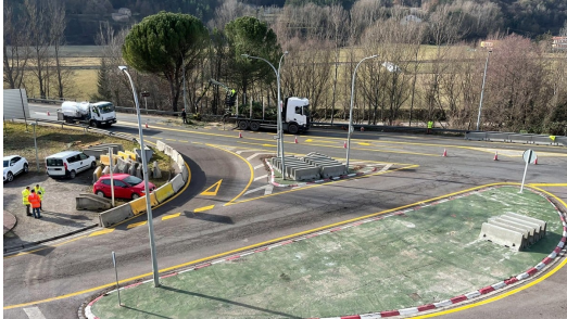
Imatge aèria de l'accés nord-est de Ripoll on s'hi construirà la nova rotonda | Ajuntament de Ripoll
