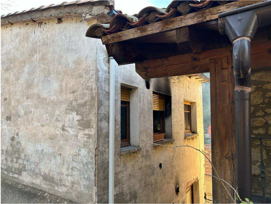
La casa incendiada amb les finestres fumades
