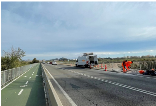
Les obres de millora al pont que uneix Blanes i Palafolls CEDIDA.
