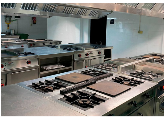
Instal·lacions de l'hotel BPM TWITTER AJ. DE LLORET DE MAR.
