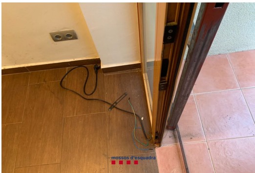
Detall d'un sistema d'electrocució instal·lat en una porta d'un habitatge que amagava una plantació de marihuana MOSSOS D'ESQUADRA.
