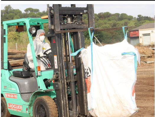
Comencen a portar el fibrociment destrossat per la pedregada a la deixalleria de la Bisbal ACN.
