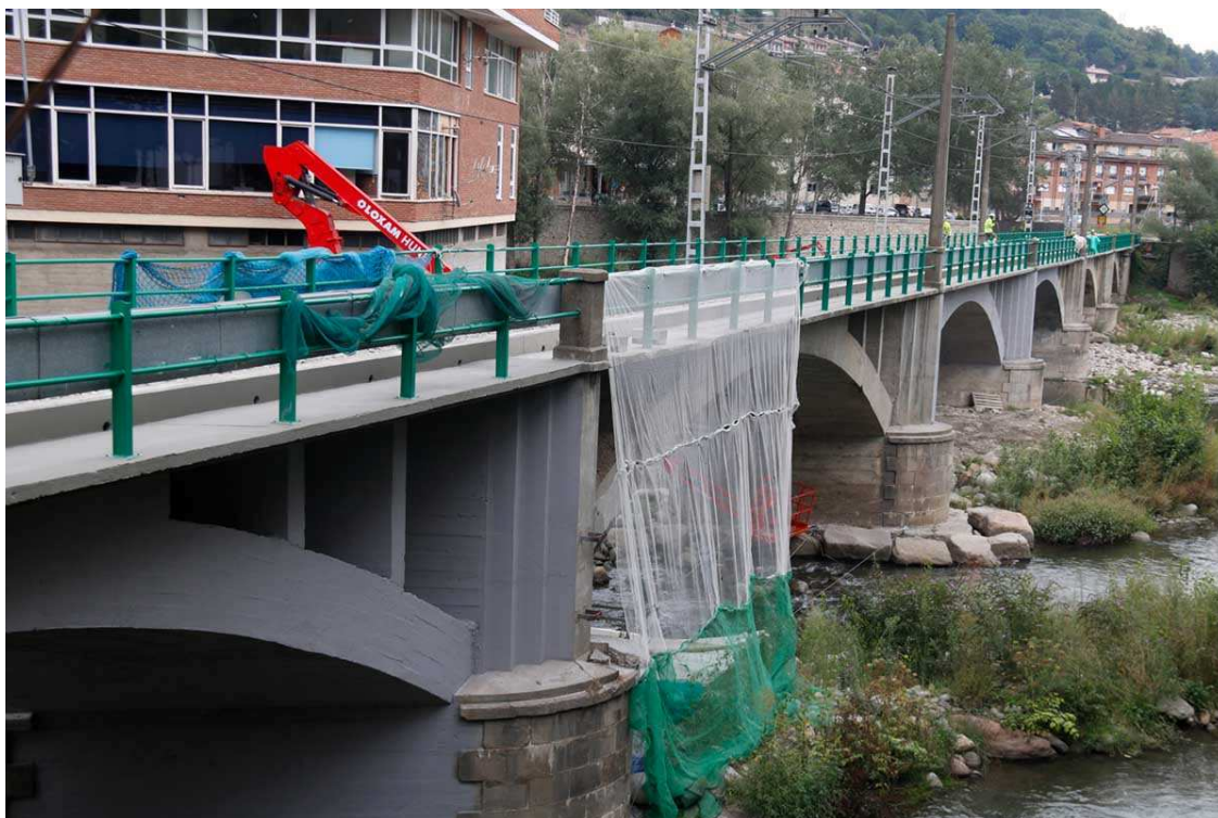
Es reprèn el servei ferroviari del R3 entre Ripoll i Puigcerdà un cop finalitzades les obres de millora del pont (Foto: ACN)
