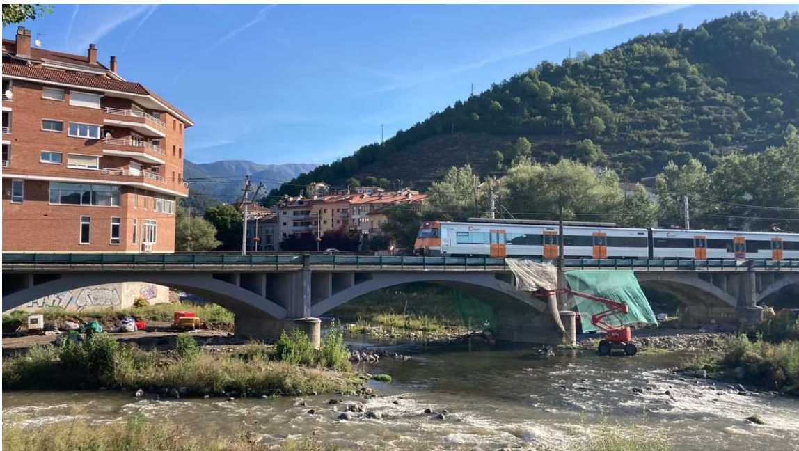
El tren passant pel pont amb el restabliment del servei ferroviari a Ripoll ACN
