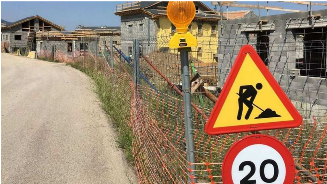
Un edifici en construcció en un dels veïnats de Bellver. | MIQUEL SPA
