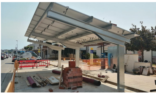
L'estructura o pèrgola de les plaques solers per a les estacions electrolinereres, a Calonge, ahir al matí J.F.
