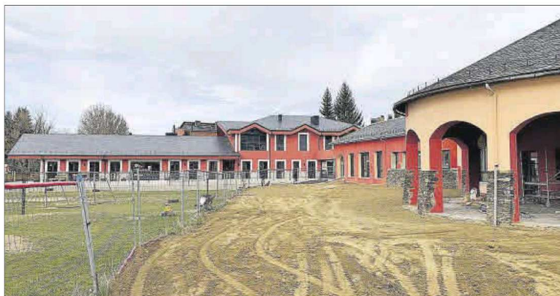
L'última fase d'obres de la nova escola de Llívia, amb els dos edificis ja connectats
