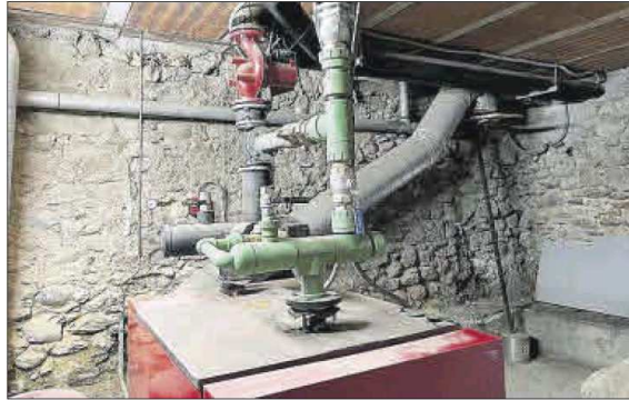
Maquinària de la caldera del teatre que se substituirà
