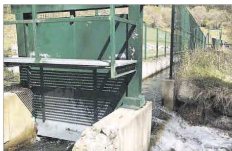
La captació actual al riu de la Llosa del Rec Gros
