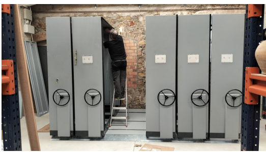
Instal·lació dels armaris compactes per a la nova biblioteca del Terracotta J.T.
