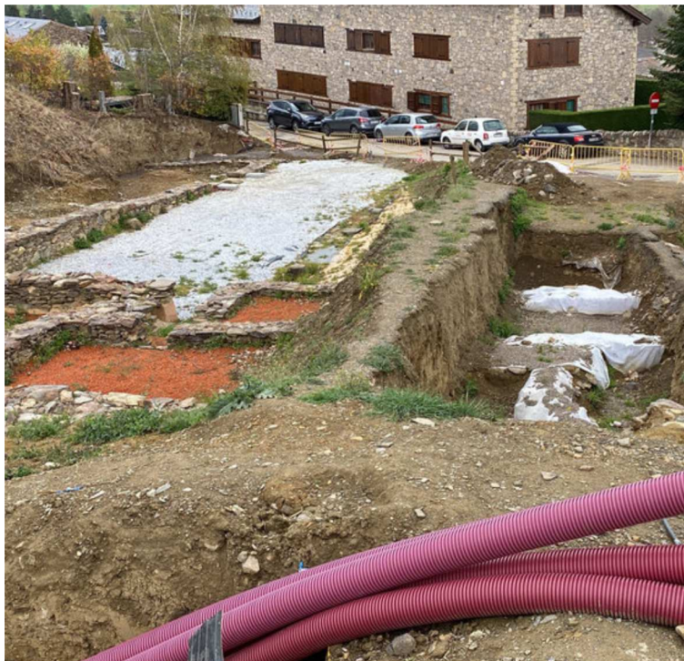
Les noves conduccions per on passen les línies de servei d'el zona del fòrum de Iulia Libica a Llivia. ACN.
