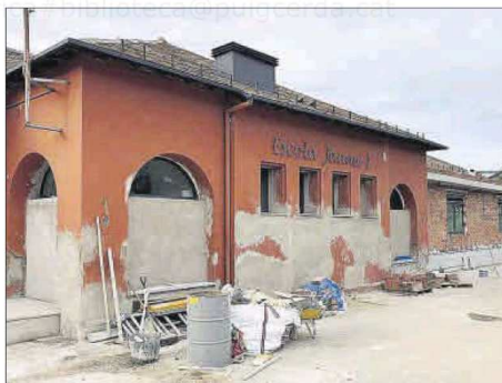
Reformes a l'edifici antic de l'escola Jaume I de Llívia AJUNTAMENT DE LLÍVIA
