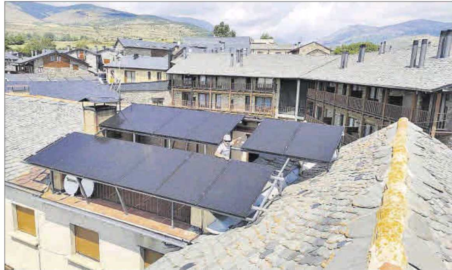
Teulades de pissarra amb plaques fotovoltaïques integrades
