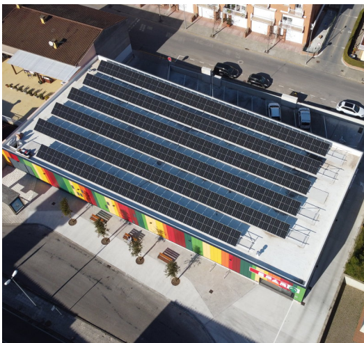
El teulat del supermercat Spar de Sant Joan les Fonts, amb les plaques fotovoltaïques EPA.
