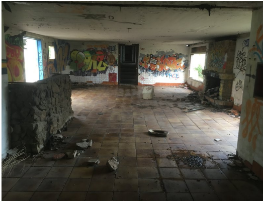
Estat d'una de les edificacions de la base Loran J. TRILLAS.
