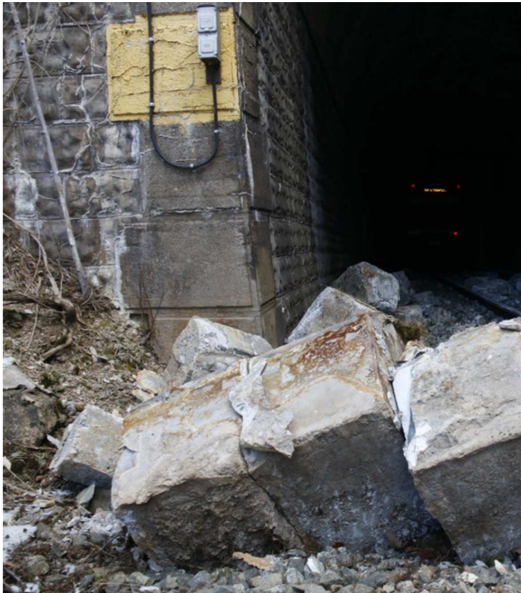
Les roques, de grans dimensions, que es van desprendre del túnel sobre la via L. CASADEMONT / ACN.
