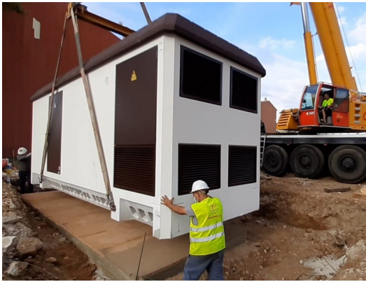
S'ha instal·lat un edifici prefabricat amb el transformador EPA.
