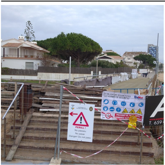
La tarima del pont sobre la riera Aubi, ja gairebé desmuntada ahir, se substitueix per un ferm de formigó E.A.
