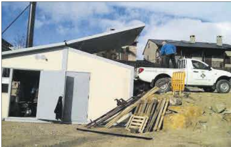
Un operari carrega la caldera de biomassa a Ger
