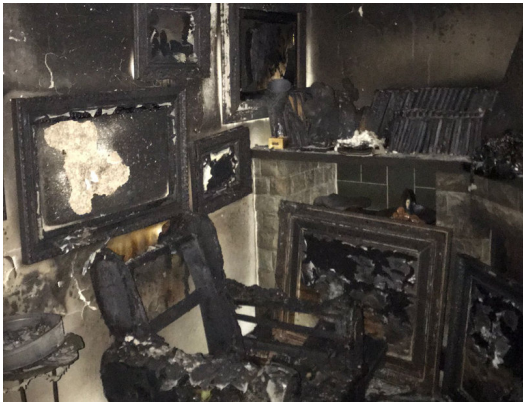
Estat en què va quedar l'immoble MOSSOS D'ESQUADRA.
