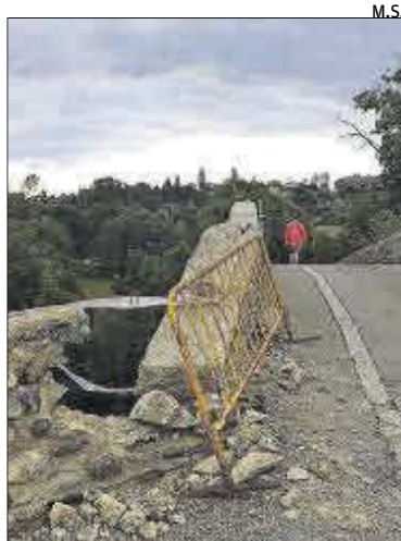
El pont malmès a l'agost
