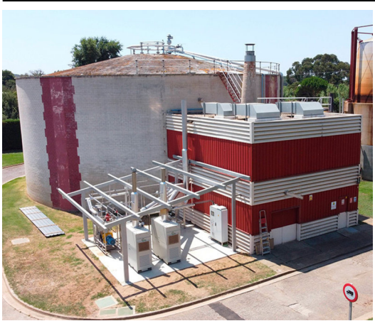
La planta de biogàs a la depuradora de Palamós, que a més dona servei a Palafrugell, Vall-llobrega i Calonge AGBAR.
