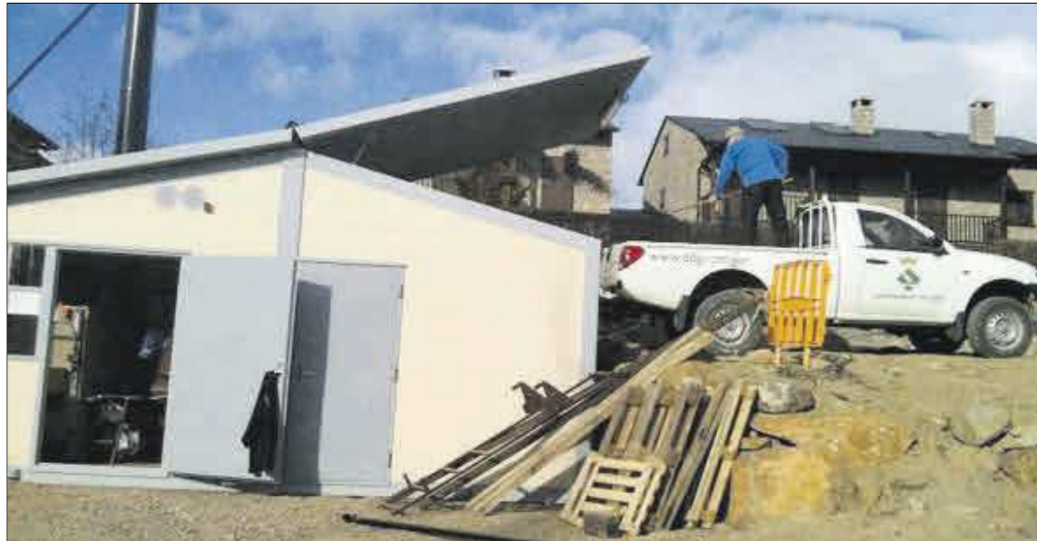
Una instal·lació municipal de biomassa de l'Ajuntament de Ger per escalfar l'escola
