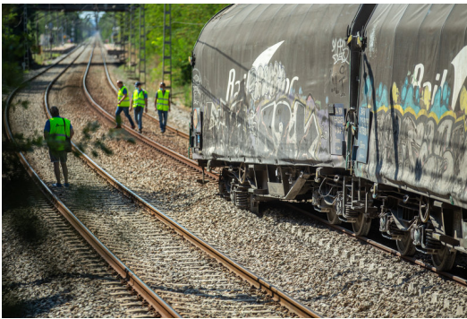
Operaris treballant ahir en el descarrilament QUIM PUIG.
