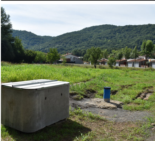
La captació d'aigua feta aquest estiu en un extrem de la urbanització de Peracaula R.E.
