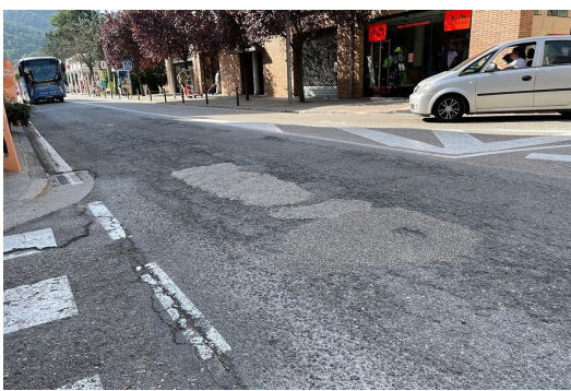
El mal estat de la calçada del carrer Progrés de Ripoll | Aj. de Ripoll
