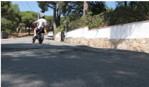
Un esvoranc, a l'itinerari de pujada a la urbanització, ahir al migdia E.A.
