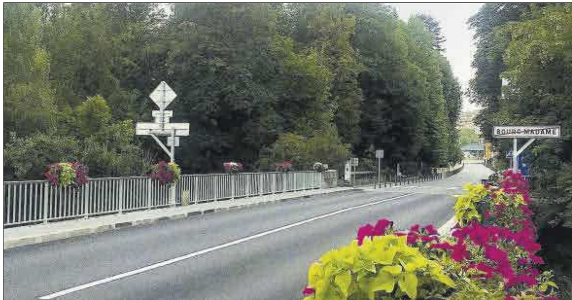
El Pont Internacional entre Puigcerdà i la Guingueta amb el nou ferm i baranes
