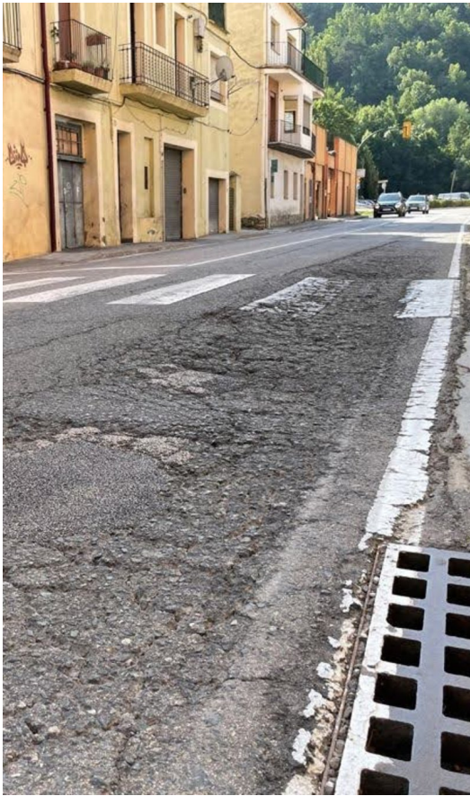
Detall de l'estat del carrer Progrés AJUNTAMENT DE RIPOLL.
