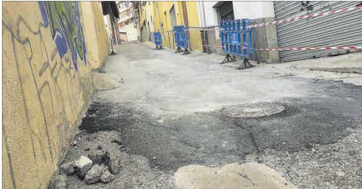
El carrer de les Beates de Puigcerdà, malmès pels temporals de pluja i vent de juny i juliol
