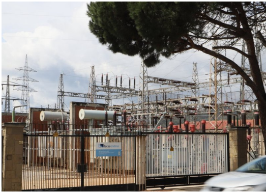
Una subestació elèctrica d'Endesa al Baix Empordà E.A.
