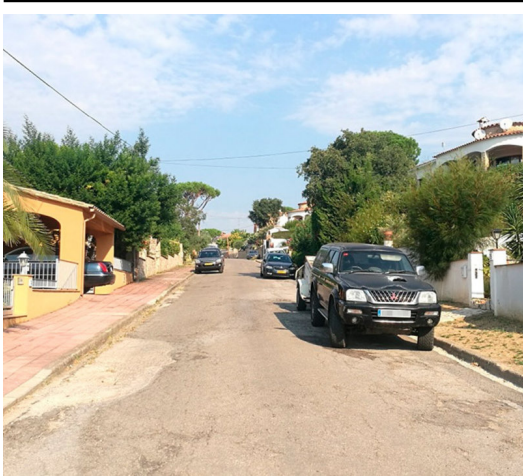
Un carrer de la urbanització de Mas Pere de Calonge, notablement degradat J.T.
