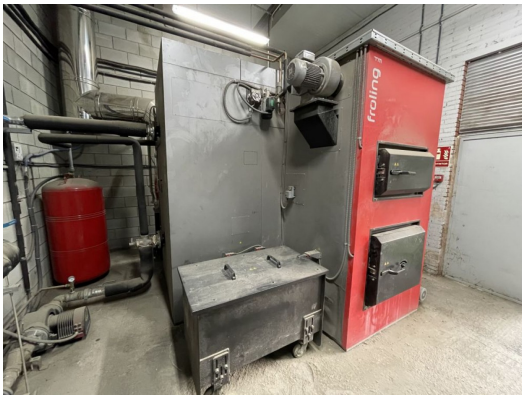
Una de les calderes de Ripoll | Ajuntament de Ripoll
