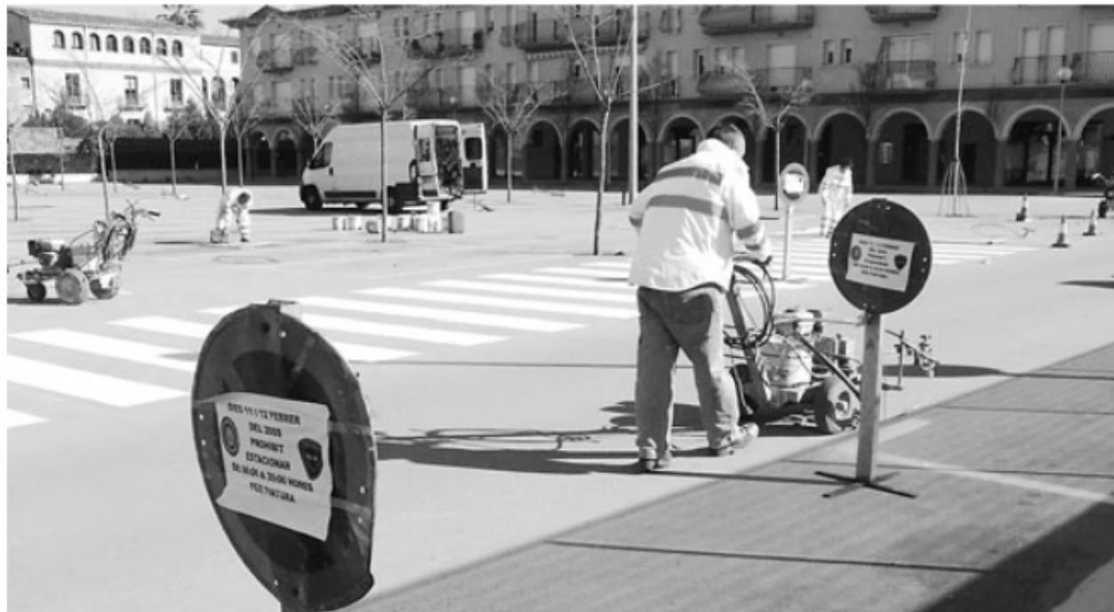
Els tècnics van acabar ahir de pintar de color blau les places d'aparcament de la plaça Carreras Dagas. / Ò.P.
