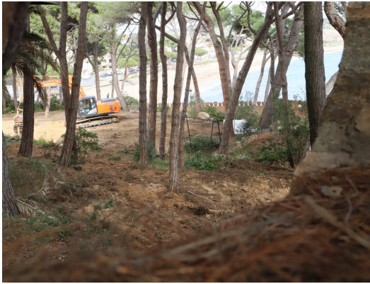
L'enderroc de la casa que ocupava fins ara una de les parcel·les E.A.
