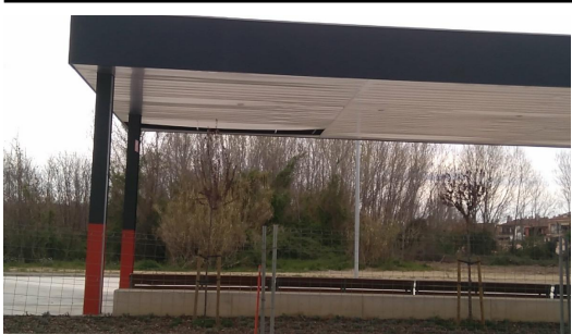
El vent va fer desprendre una planxa del sostre
